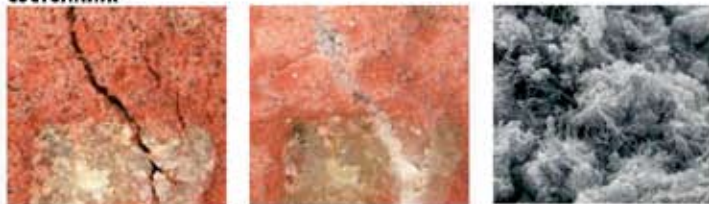
Образование трещин на поверхности бетона.
